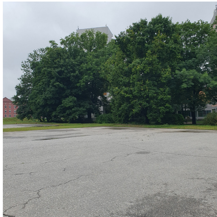
Stávající betonová plocha Popraskaná asfaltová plocha
